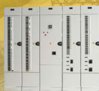
Rozdzielnice obwodów pomocniczych z przełącznikami ATYS
